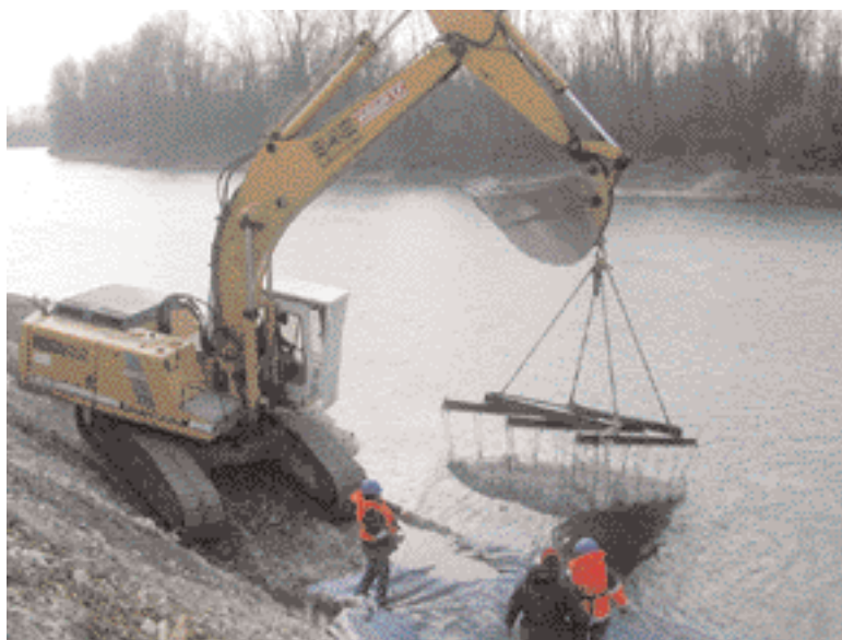
Photo 7 Mise en eau des matelas de gabions par palonnier Placing gabion mattresses in the water by lifting beam
