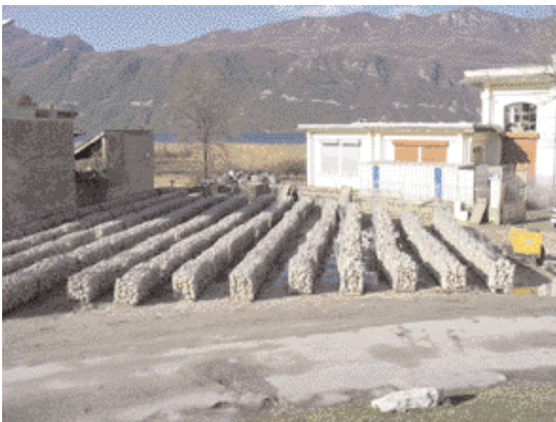
Photo 1 Stockage et préparation des gabions à terre Storing and preparing the gabions on land
